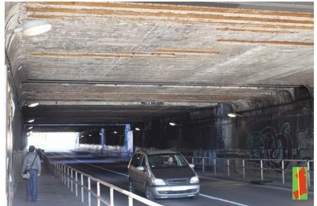
S-Bahn Bochum Langendreer / B 235 Angstraum / instandsetzungsbedürftige Brücke
